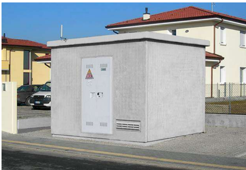
Figura 38 – Esempio di cabina elettrica di distribuzione in struttura permanente
