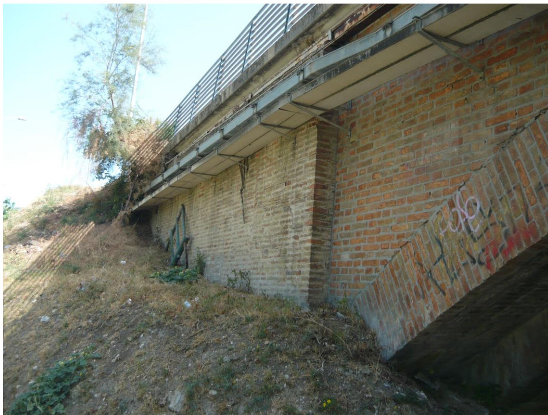
Foto 3 – Canaline ponte su Arzilla SS16
