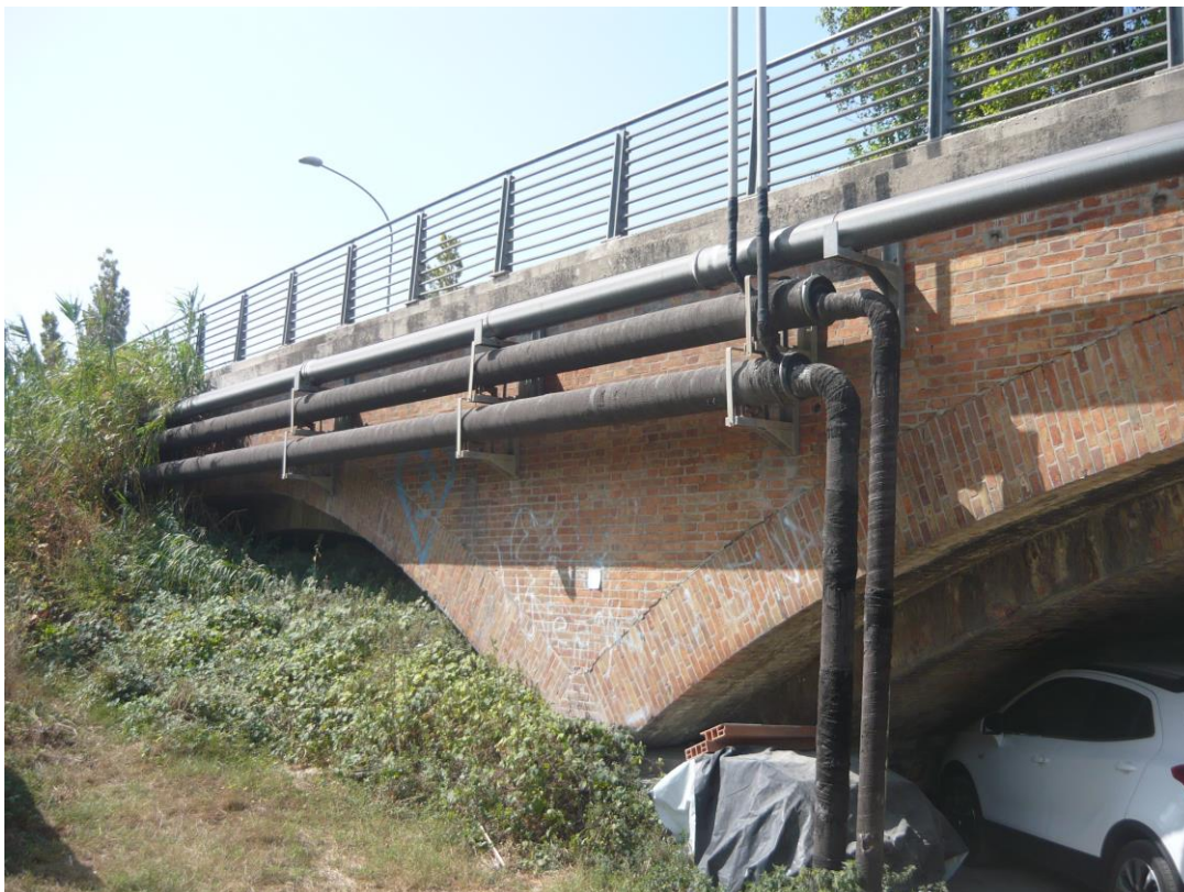
Foto 2 – Condotte gas metano viale I Maggio
