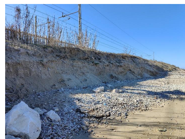
Erosione lungo la massicciata ferroviaria
