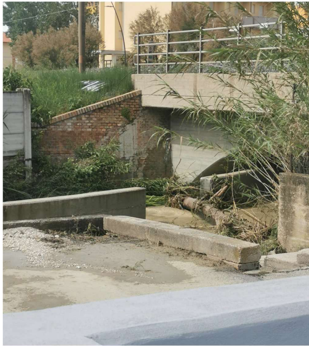
Fig. 14–Attraversamento ferroviario al km 166+023 – Vista di monte -piena maggio 2023
