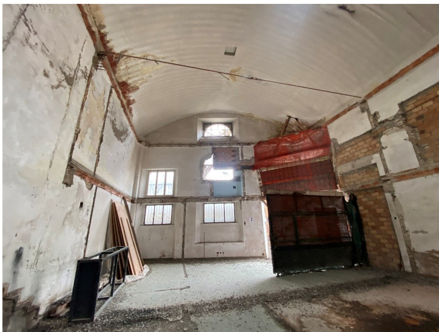
Figura 28: Fotografia stato attuale dove si evidenziano le manomissioni all'edificio 1
